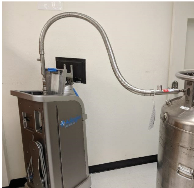
Figure 80 – Connexions réalisées pour le remplissage
