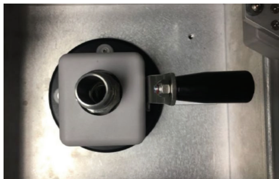
Robinet de remplissage ouvert
